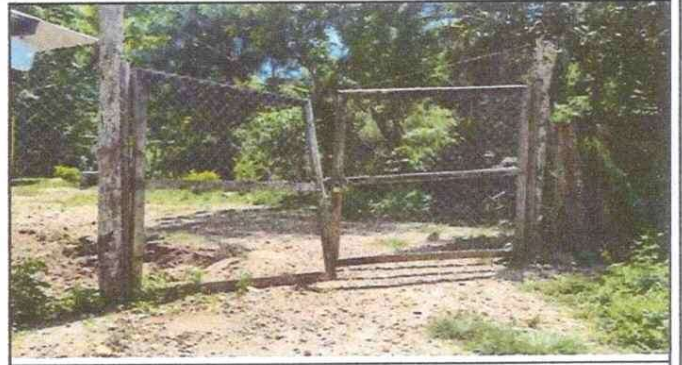
Foto 2: Portón principal provisional de madera para sustituir por portón de metal (con barrotes)
