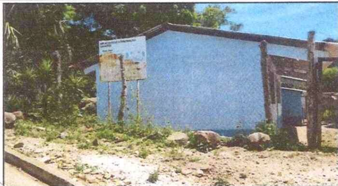
Foto 1: Muro perimetral en mal estado, necesita sustitución de malla con base de block y tubo galvanizado y columnas de concreto
