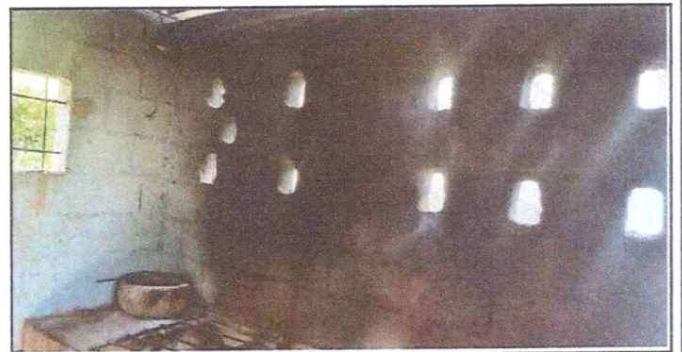
Foto 6: Ventilación e iluminación de cocina en condiciones, desfavorables, se requiere ventanal de barrotes.
