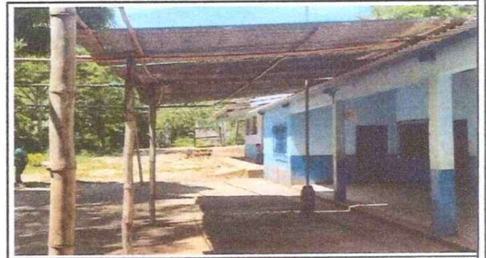
Foto 4: Lámina de galera-corredor con serios daños ocasionados por el viento, a sustituir con lámina troquelada calibre 26
