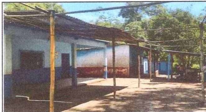
Foto 3: Estructura de soporte de techo en galera-corredor con madera y bambú, necesita sustituir con estructura metálica.
