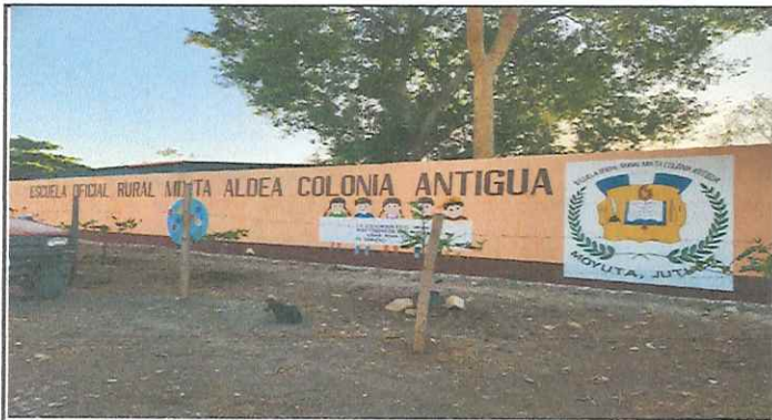
TAPIAL DE FRENTE EN BUEN ESTADO.
