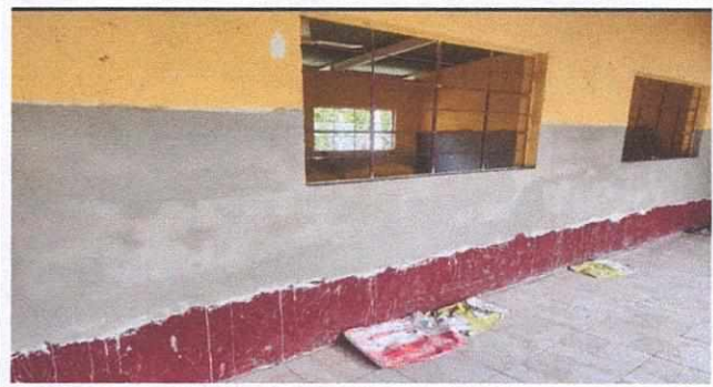
Foto 2: MEJORAMIENTO DE PARED EN MAL ESTADO
