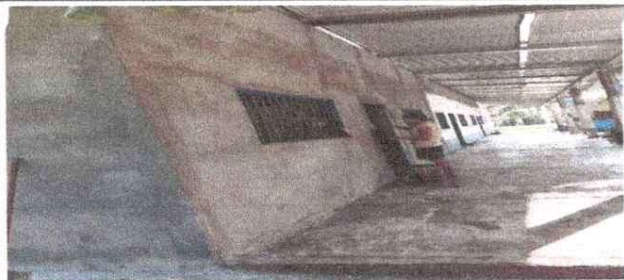
Foto 1: REPELLO DE LAS AULAS Y COCINA
