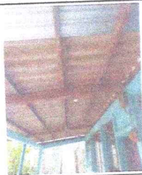
Foto 3: Substitución de techo de fibrocemento en mal estado por lámina troquelada calibre 26 modulo 2
