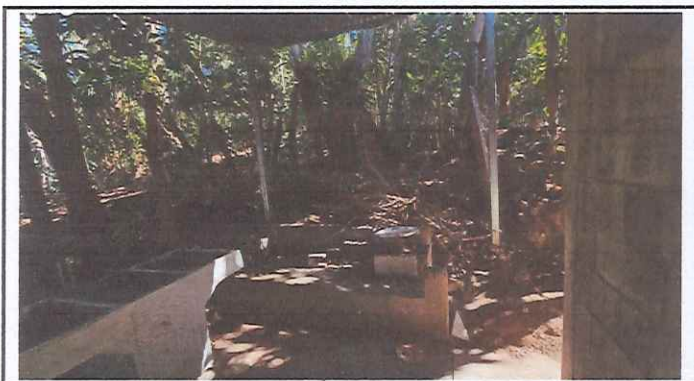
MEJORAMIENTO DE POLLETON, CIRCULACION Y PISO DE COCINA EN MAL ESTADO.
