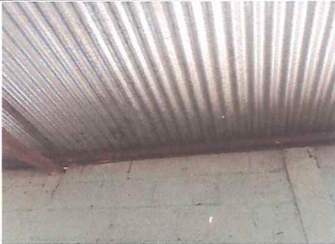
Se necesita mantenimiento de estructura de tcho y mantenimiento de lámina
