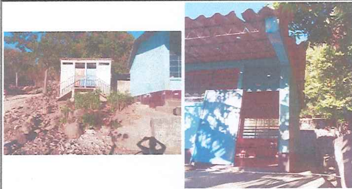
Foto 3: Puertas en mal estado, deterioro por oxido.
