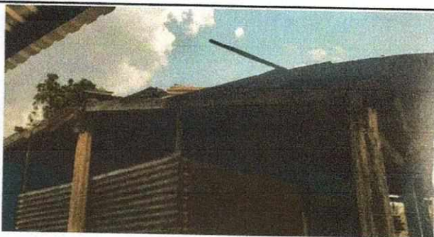
FOTO No. 5 Techo en mal estado
