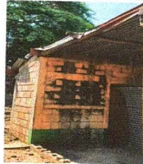
FOTO No. 4 Techo de Baños
