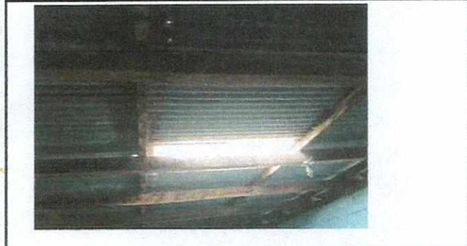
FOTO No. 1 Techo en mal estado de los salones de clase
