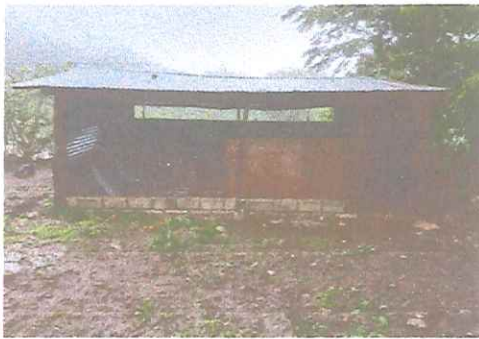
Foto 3: Mejoramiento de aula lateral, sin torta, sin malla y tubo galvanizado, sin puerta, sin block solo una hilada de block para mayor seguridad.
