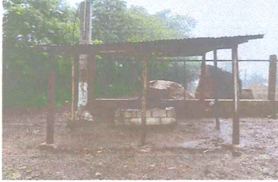
Foto 1: Mejoramiento de cocina sin pared, sin techo, sin torta, instalación de pila y puerta para mayor seguridad.
