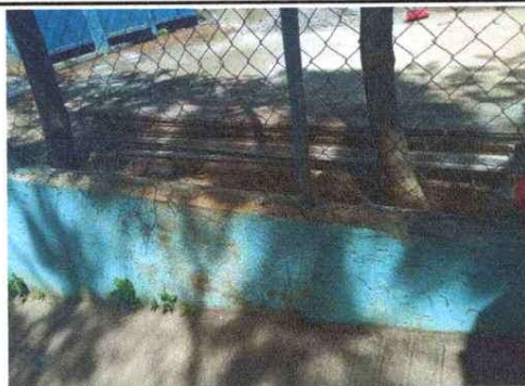
Foto 2: Malla en mal estado
