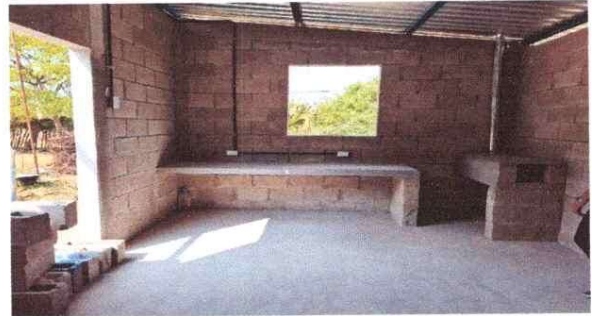
Foto 4: torta de concreto
