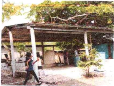
FOTO No. 1 Cocina sin Paredes
