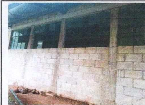
FOTO No.03 Ventanales, puerta y piso
