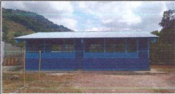
Foto 1: FINALIZACIÓN DE SUSTITUCIÓN DE LAMINA POR LAMINA TROQUELADA EN MODULO DE AULAS
