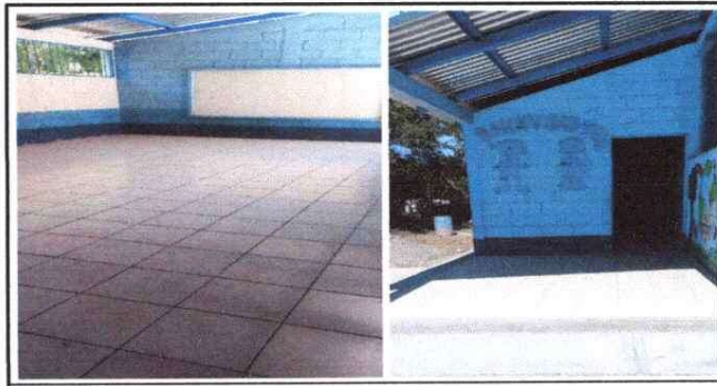
Demolición y retiro de piso de granito existene, fundición de base e instalación de Piso en aulas.
