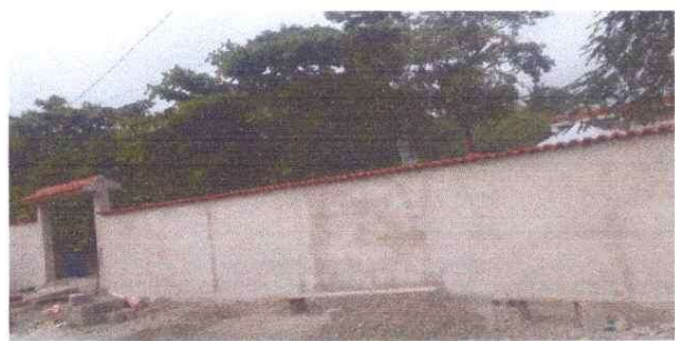
Se Sustitución de todo el Muro por que no tenia suficiente hierro en la fundición
