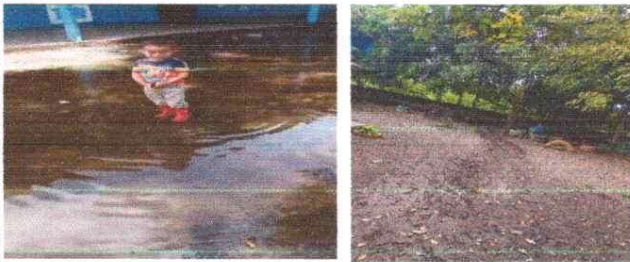
Sustitución de tubería de cemento por tubería PVC línea principal de aguas
