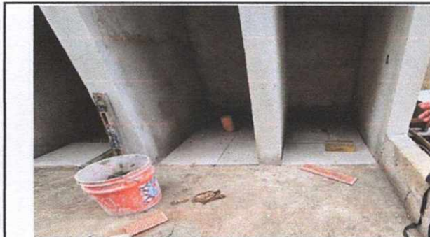
Sustitucion de piso de torta por ceramico antideslizante en interior de sanitarios.
