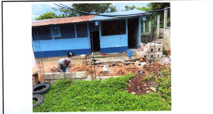
En proceso de reparación de muro perimetral a un costado de la escuela
