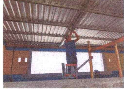
INSTALACIÓN DE ENERGÍA ELÉCTRICA
