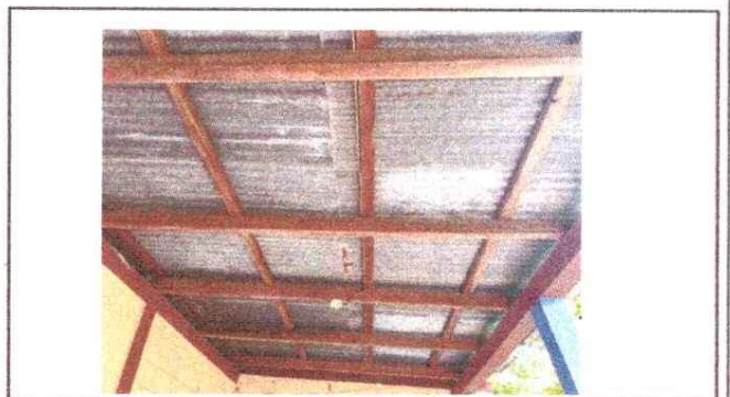
SE NECESITA CAMBIO DE TECHO
