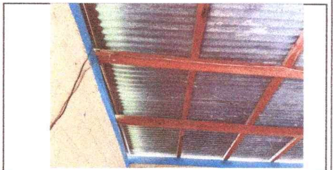
SE NECESITA INSTALACIÓN DE ENERGIA ELÉCTRICA
