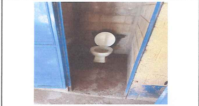
BAÑOS: Se necesita sustitución de lámina, estructura de soporte de metal, sustitución de tubería línea principal, sustitución de inodoros y accesorios.
