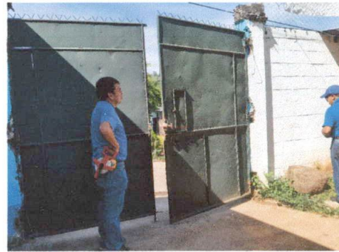
Foto 2: Portón de ingreso en mal estado
