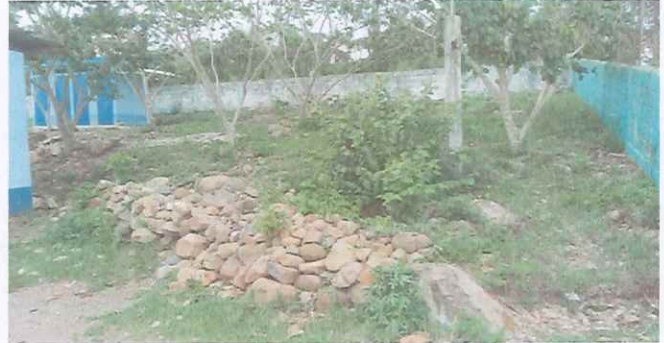
FOTO 4. MURO EN MAL ESTADO, REMOZAMIENTO COMPLETO DE MURO DE PIEDRA
