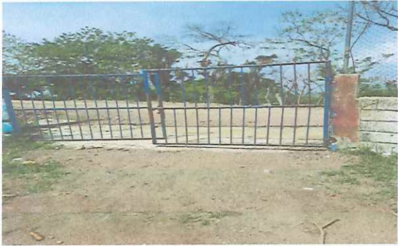
FOTO 1. PARTON EN MAL ESTADO, SE NECESITA REPARACION DEL MISMO
