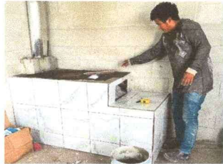
REMOSAMIENTO DE PLANCHA DE COCINA DURANTE
