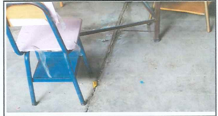
PISO EN MAL ESTADO
