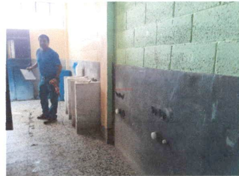
Foto 10: Falta base de lavamanos
