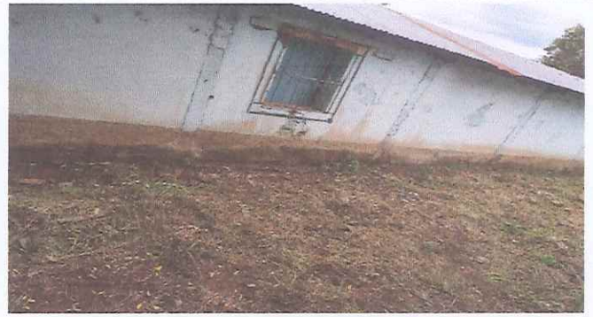
CUNETA EN MAL ESTADO, NECESITA REPARACIÓN DE CONCRETO
