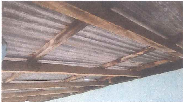
COSTANERAS Y CUARTONES EN MAL ESTADO, NECESITAN CAMBIO
