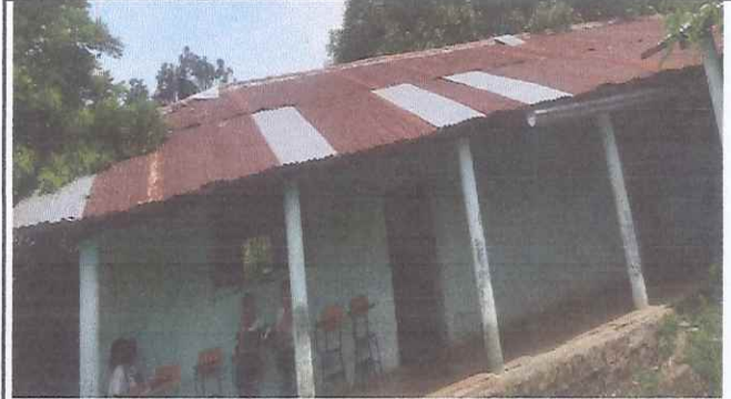
LAS LÁMINAS ESTÁN EN MAL ESTADO, NECESITAN CAMBIO
