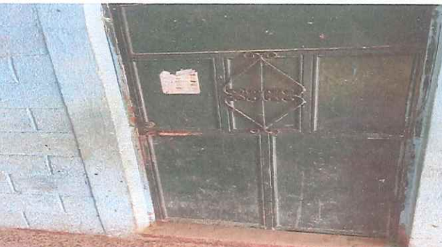
PUERTAS DETERIORADAS, NECESITAN MANTENIMIENTO
