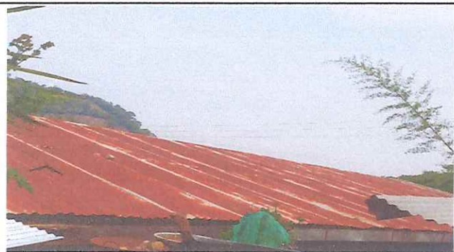
LAMINA EN MAL ESTADO, SE NECESITA CAMBIO
