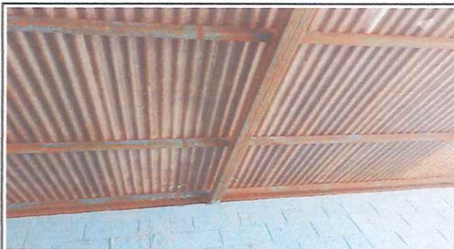
ESTRUCTURA METALICA EN MAL ESTADO SE NECESITA CAMBIO
