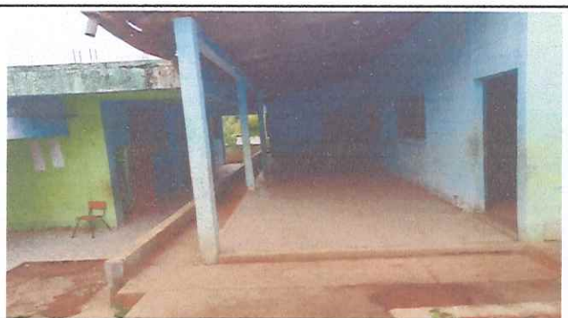
DETERIORO DE PINTURA NECESITA SER RENOVADA
