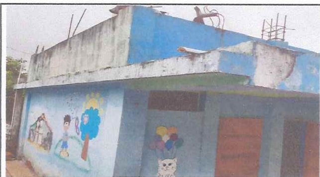
DETERIORO DE PINTURA NECESITA SER RENOVADA
