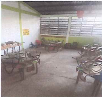
Foto 5: Se colocara piso cerámico en 4 aulas para prestas mejor servicio a los estudiantes ya que son niños y pueden lastimarse con lo rustico de la torta de concreto.
