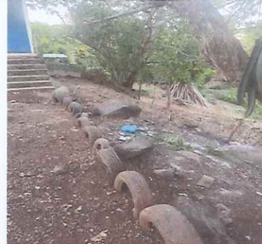
Foto 2: Se construirá un muro de protección para los niños ya que la escuela no cuenta con proyección perimetral en este sector de la misma.
