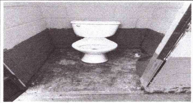
Foto 2: Sanitario antes de remodelar
