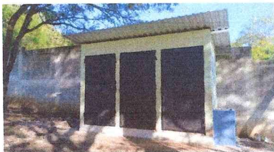
SERVICIO DE SANITARIOS: PUERTAS EN MAL ESTADO NECESITA SUSTITUCIÓN, BANQUETA NECESITA REPARACIÓN, LAMINAS NECESITAN SUSTITUCIÓN, SE NECESITA LAVAMANOS.
