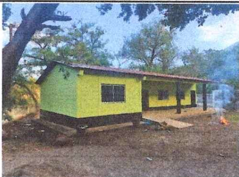
SE NECESITA PINTURA EN PAREDES DE AULAS MODULO 2
