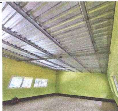
LAMINA Y ESTRUCTURA DE AULAS MODULO 1 EN MAL ESTADO, NECESITAN SUSTITUCIÓN, PAREDES MUY BAJITAS NECESITAN LEVANTADO
