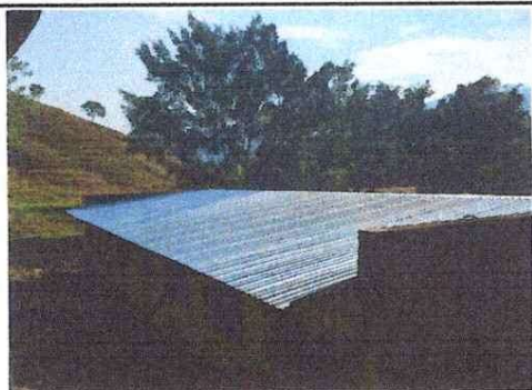
LAMINA Y ESTRUCTURA DE AULAS MODULO 1 EN MAL ESTADO, NECESITA SUSTITUCIÓN
