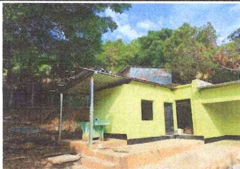
LAMINA DE TECHO DE COCINA EN MAL ESTADO, NECESITA SUSTITUCIÓN
