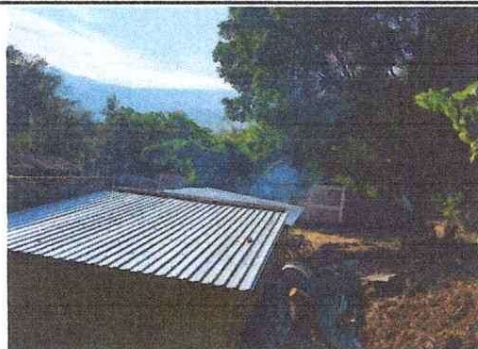
TECHO DE BODEGA EN MAL ESTADO NECESITA SUSTITUCIÓN DE LAMINA
