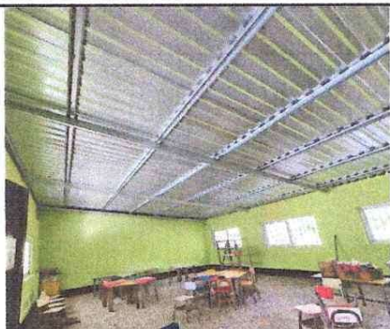
LAMINA Y ESTRUCTURA DE AULAS MODULO 1 EN MAL ESTADO, NECESITAN SUSTITUCIÓN, PAREDES MUY BAJITAS NECESITAN LEVANTADO
