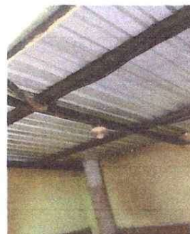
LAMINA DE TECHO DE COCINA EN MAL ESTADO, NECESITA SUSTITUCIÓN
