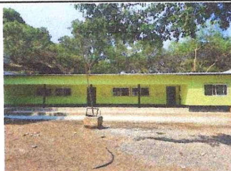
SE NECESITA PINTURA EN PAREDES DE AULAS MODULO 1
