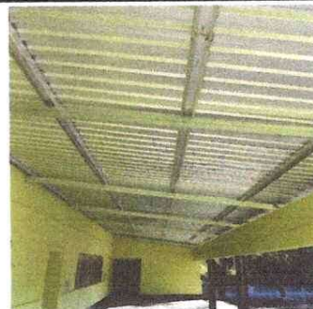
LAMINAS DE CORREDOR CON AGUJEROS NECESITAN SUSTITUCIÓN, AL IGUAL QUE LA ESTRUCTURA
