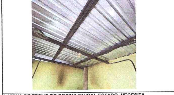
LAMINA DE TECHO DE COCINA EN MAL ESTADO, NECESITA SUSTITUCIÓN
