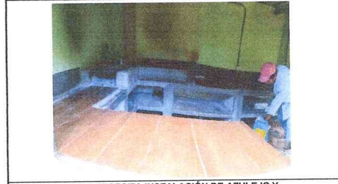
MESA DE COCINA NECESITA INSTALACIÓN DE AZULEJO Y LAVATRASTOS PARA UNA MEJOR HIGIENE EN LA PREPARACIÓN DE ALIMENTOS
