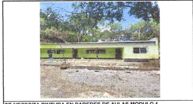
SE NECESITA PINTURA EN PAREDES DE AULAS MODULO 1
