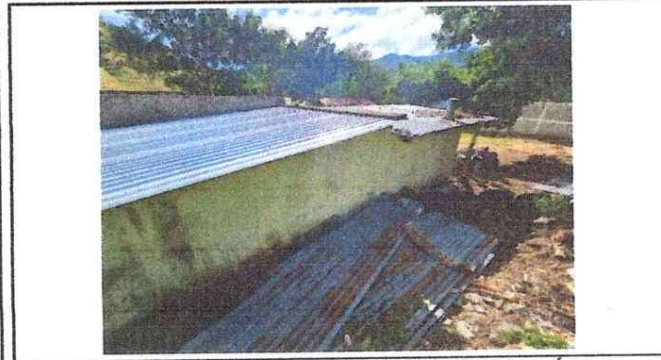
TECHO DE BODEGA EN MAL ESTADO NECESITA SUSTITUCIÓN DE LAMINA
