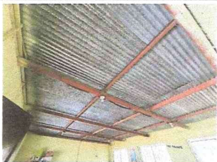
LAMINA Y ESTRUCTURA DE AULAS MODULO 1 EN MAL ESTADO, NECESITAN SUSTITUCIÓN, PAREDES MUY BAJITAS NECESITAN LEVANTADO
