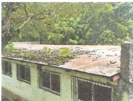
LAMINA Y ESTRUCTURA DE AULAS MODULO 1 EN MAL ESTADO, NECESITA SUSTITUCIÓN
