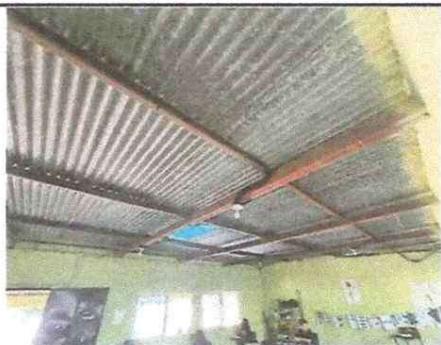
LAMINA Y ESTRUCTURA DE AULAS MODULO 1 EN MAL ESTADO, NECESITAN SUSTITUCIÓN, PAREDES MUY BAJITAS NECESITAN LEVANTADO
