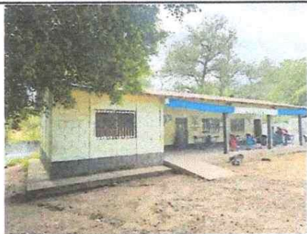
SE NECESITA PINTURA EN PAREDES DE AULAS MODULO 2
