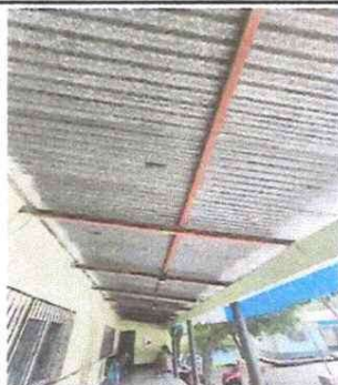
LAMINAS DE CORREDOR CON AGUJEROS NECESITAN SUSTITUCIÓN, AL IGUAL QUE LA ESTRUCTURA
