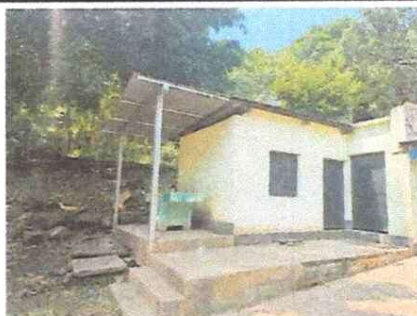
LAMINA DE TECHO DE COCINA EN MAL ESTADO, NECESITA SUSTITUCIÓN
