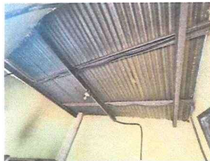
LAMINA DE TECHO DE COCINA EN MAL ESTADO, NECESITA SUSTITUCIÓN
