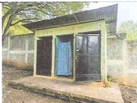
SERVICIO DE SANITARIOS: PUERTAS EN MAL ESTADO NECESITA SUSTITUCIÓN, BANQUETA NECESITA REPARACIÓN, LAMINAS NECESITAN SUSTITUCIÓN, SE NECESITA LAVAMANOS.
