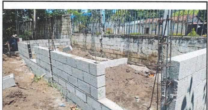
Foto 2: Area de cocina sin piso, muros no alcanzan el techo, sin azulejo
