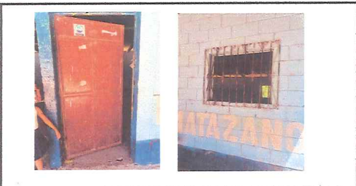
Foto 5: puertas y ventanas ,pintura deteriorada, realizar limpieza y pintura de ambas , cambio de chapa en puertas.
