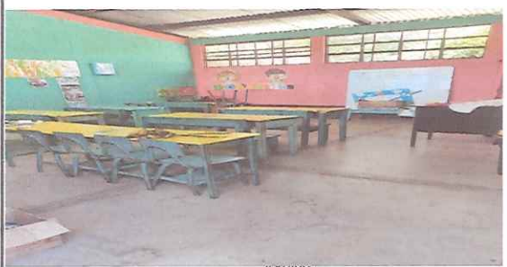
Las aulas carecen de piso,
