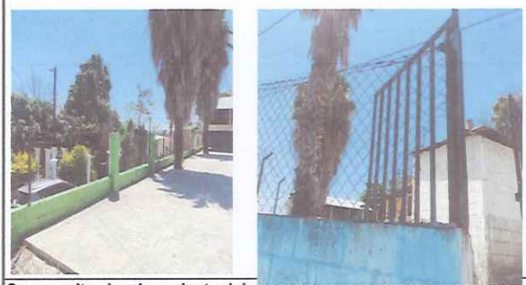
Se necesita el mejoramiento del muro perimetral, el cual la malla se encuentra en mal estado
