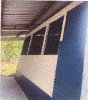
Foto3: MANTENIMIENTO DE VENTANERIA, SUSTITUCION DE VIDRIO POR LÁMINA DESPLEGADA Y MANTENIMIENTO DE PUERTAS
