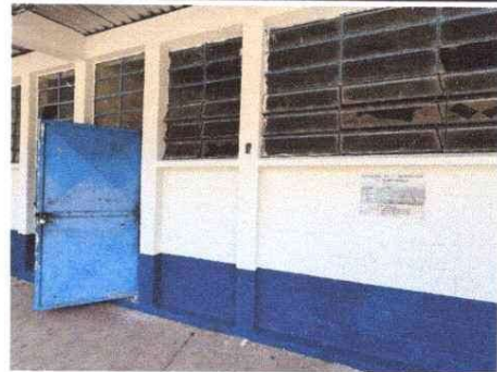
Foto 2: MANTENIMIENTO DE VENTANERIA, SUSTITUCIÓN DE VIDRIO POR LÁMINA DESPLEGADA Y MANTENIMIENTO DE PUERTAS
