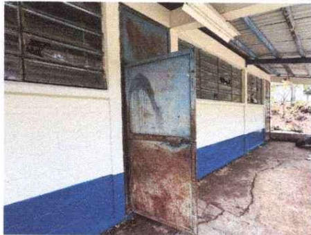
Foto 3: MANTENIMIENTO DE VENTANERIA, SUSTITUCIÓN DE VIDRIO POR LÁMINA DESPLEGADA Y MANTENIMIENTO DE PUERTAS
