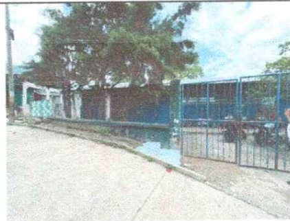
Foto 3: MURO EXISTENTE EN MAL ESTADO
