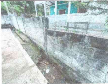
Foto 1: MURO EXISTENTE EN MAL ESTADO
