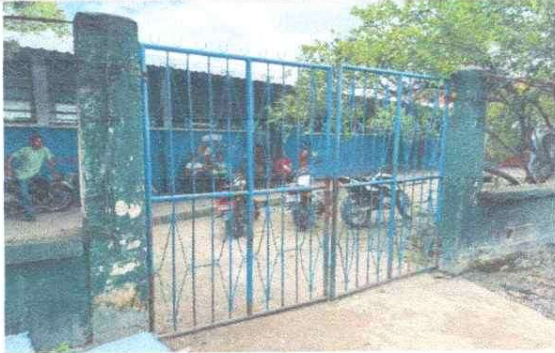
Foto 7: PORTON METALICO EN MAL ESTADO
