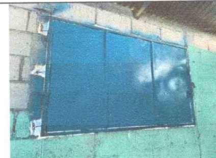
Foto 6: VENTANERIA METALICA EN MAL ESTADO
