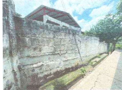
Foto 2: MURO EXISTENTE EN MAL ESTADO
