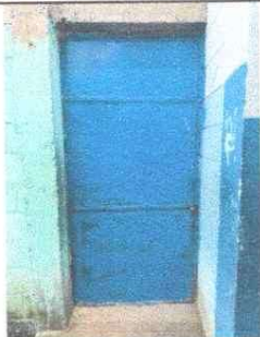
Foto 5: PUERTA METALICA EN MAL ESTADO
