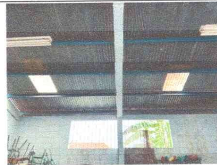
Foto 4: CARENCIA DE VENTANERIA PVC
