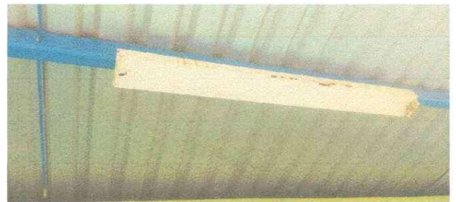
Foto 4: MEJORAMIENTO DE SISTEMA ELECTRICO GENERAL
