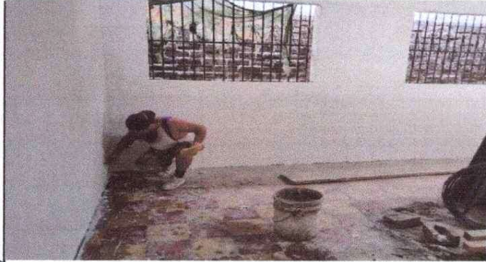
FOTO 1: AREA DE PARED EN MAL ESTADO, SE ESTÁN REALIZANDO ACABADOS TIPO CERNIDO VERTICAL
