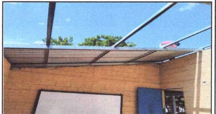
FOTO 2: ESTRUCTURA DE SOPORTE DE MADERA EN MAL ESTADO, SE ESTÁN SUSTITUYENDO POR ESTRUCTURA DE METAL
