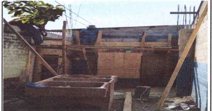
FOTO 4: TECHO EN MAL ESTADO JUNTO CON SU ESTRUCTURA, SE ESTÁ OPTANDO POR UN ARREGLO PERMANENTE CON LOSA FUNDIDA DE CONCRETO ARAMADO
