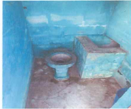
Foto 2: Sanitario con deterioro de techo, inodoro y piso de cemento, paredes sin repello, se cambiará el inodoro por uno de porcelana, cambio de techo, instalación de piso y azulejos y repello de paredes.
