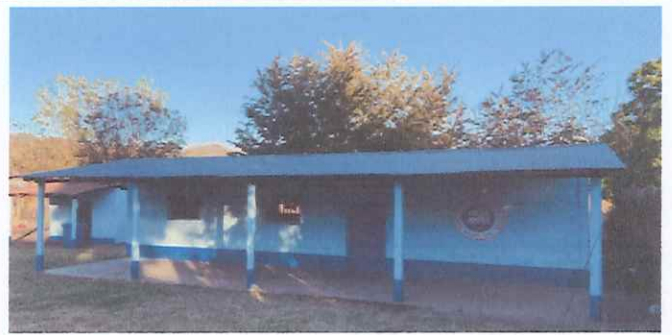
Foto 4: Deterioro de techo, piso de cemento, puerta, ventanas y paredes sin repello, se cambiará lo deteriorado, se instalará piso de granito, repellarán y pintarán las paredes.
