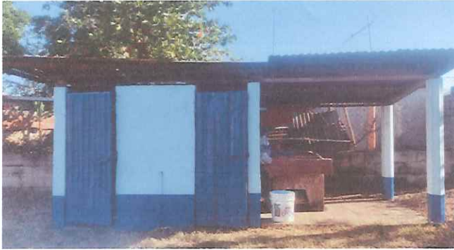
Foto 1: Techo y puertas en mal estado, escases de agua y paredes sin repello, se fundirá el techo con terraza y se instalará un tinaco y lavamanos, cambio de puertas y repello de paredes.
