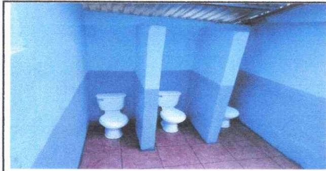
Foto1: PUERTA: Se instalarán puertas nuevas en los baños por estar en mal estado
