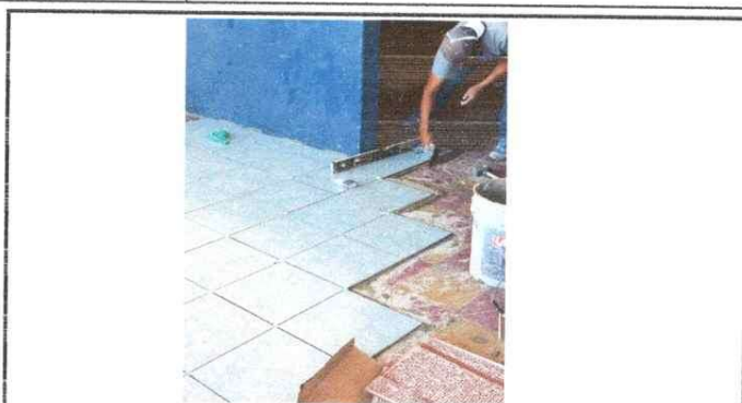
Foto 2: Piso del Centro Educativo deteriorado. Se sustituirá en su totalidad.
