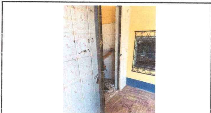
Foto 3: Mal estado de piso en Servicios Sanitarios. Se sustituirá en su totalidad.
