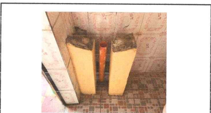
Foto 4: Lavamanos de Servicios Sanitarios en total deterioro. Sustitución total
