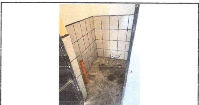
Foto 5: Servicios Sanitarios fuera de servicio por mal estado. Sustitución total.
