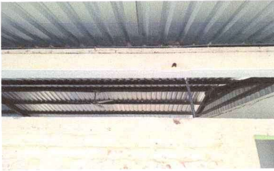
Foto 1. Balcones de los ventanales de las aulas que necesitan cambio por su deterioro
