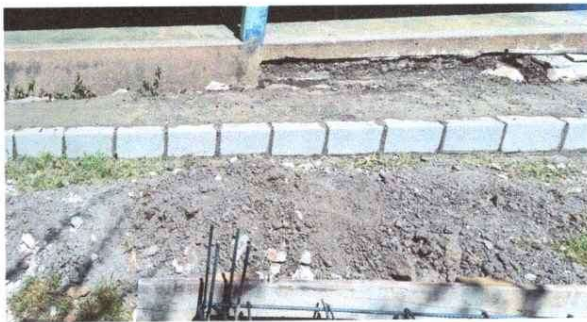
Foto 3. Gradas para subir el corredor del cventro educativo que necesitan reconstrucción.
