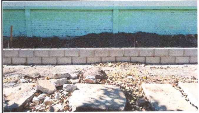
Foto 2. Zona de la banqueta del edificio educativo que necesitan reconstrucción completa
