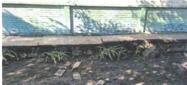
Foto 2. Zona de la banqueta del edificio educativo que necesitan reconstrucción completa
