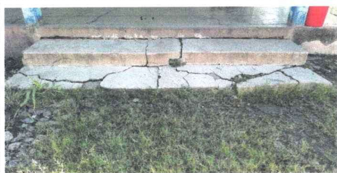
Foto 3. Gradas para subir el corredor del cventro educativo que necesitan reconstrucción.
