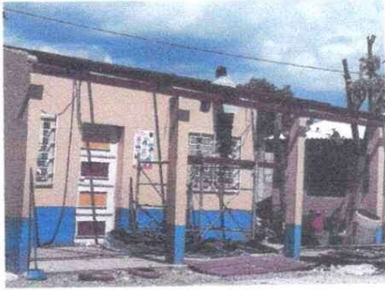
Foto 1: Lámina en mal estado, se sustituirá
